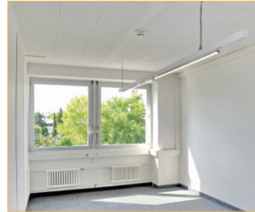
Blick in einen Konferenzraum: Hier wurden bestehende Stromschienen einfach umgebaut und mit entsprechenden Adaptern konnten die LED-Röhren eingesetzt werden, um massiv Kosten zu sparen: Funktionalität und Schlichtheit für gutes Licht.
