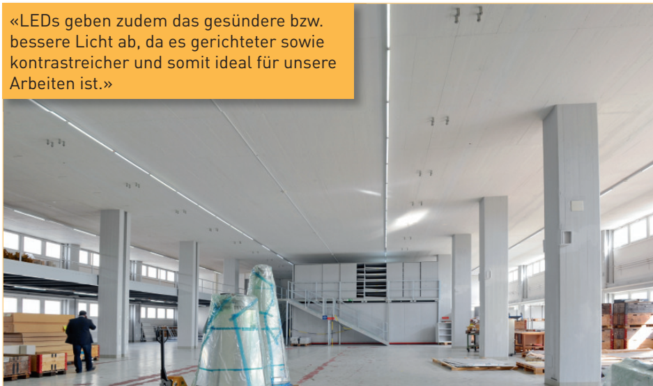
Blick in die Lagerhalle: Hier erkennt man gut die vier LED-Röhren-Stränge, die eine gleichmässige, flackerfreie Beleuchtung des Raumes auf Knopfdruck ermöglichen.
