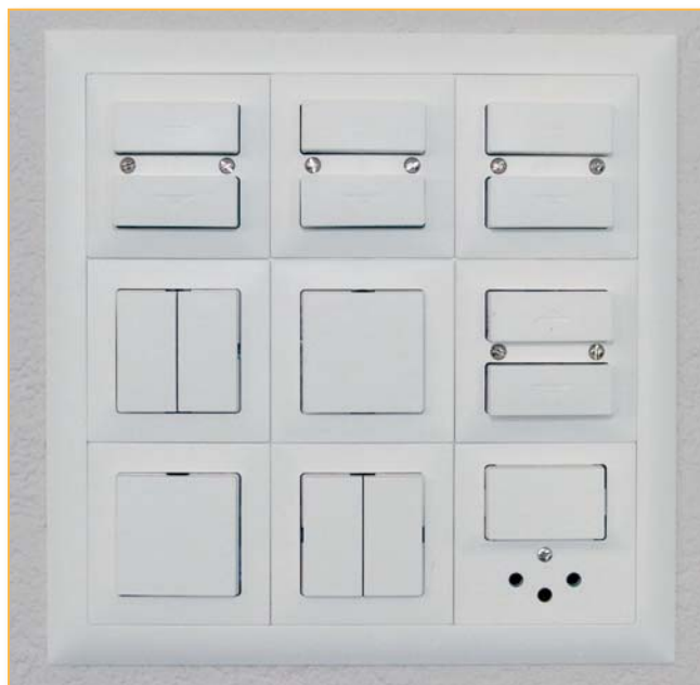
Das Tastenfeld im Wohn-/Esszimmer- und Küchenbereich, um Licht und Jalousien zentral zu steuern.
